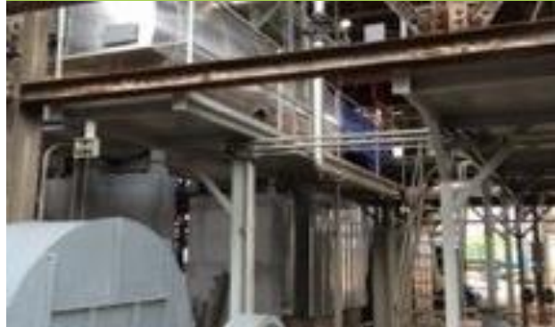
Chaudière à biomasse + turbines = cogénération
