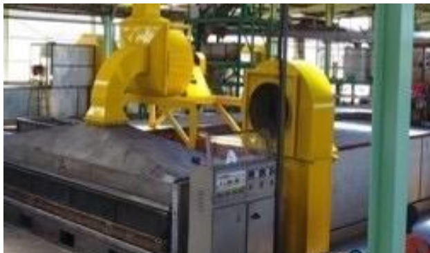
Séchoir à biomasse
